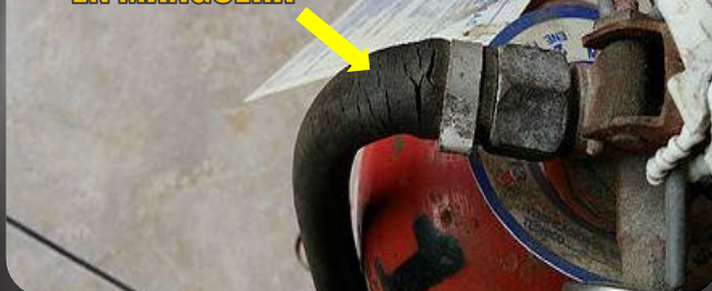
DAÑO EN EXTINTOR POR AGRIETAMIENTO EN MANGUERA
